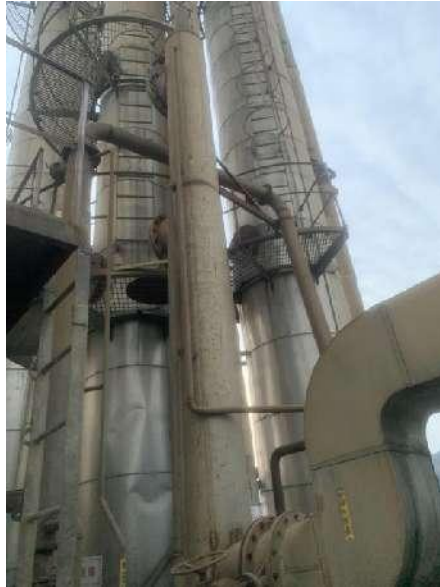
脱氨废气处理设施
